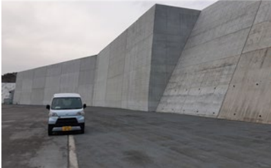
図5. 岩手県・小本川河口防潮堤
